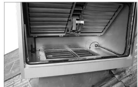
Imaginea 43: Filtru aer evacuat
